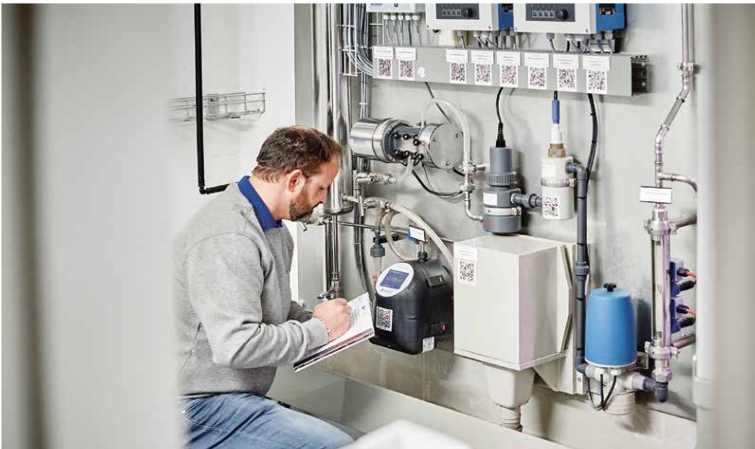
53 – An den wichtigsten Stellen bei der Wassergewinnung und den Abgabestellen sind In-Prozess-Messungen zur ständigen Überwachung installiert.
