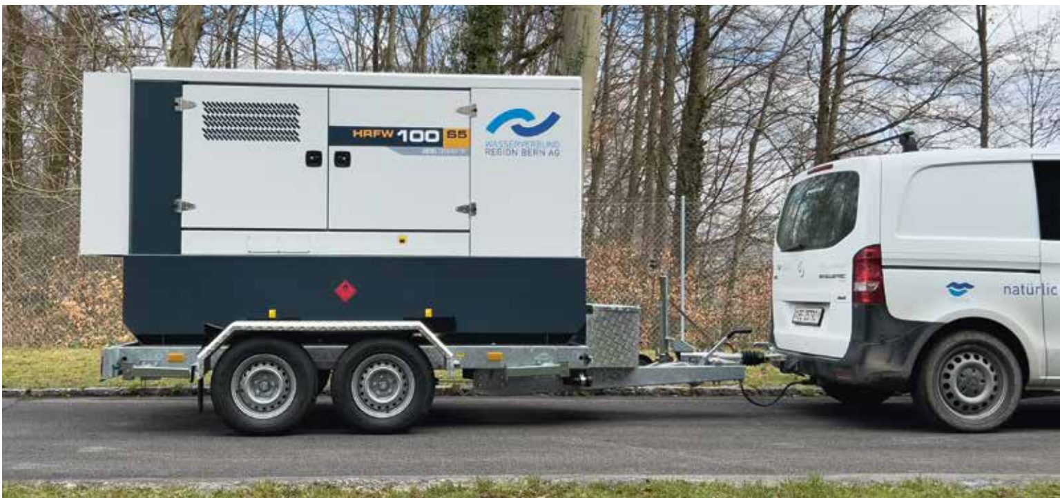
22 – Mobile Notstromgruppe der WVRB AG zum Betreiben der Pumpwerke.
