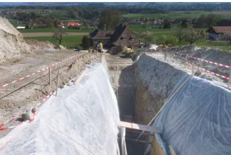
47 – Sanierung des Quellgebietes Lochmatt in Wohlen. Die Aufwände für das Fassen des Wassers in grossen Tiefen sind enorm.
