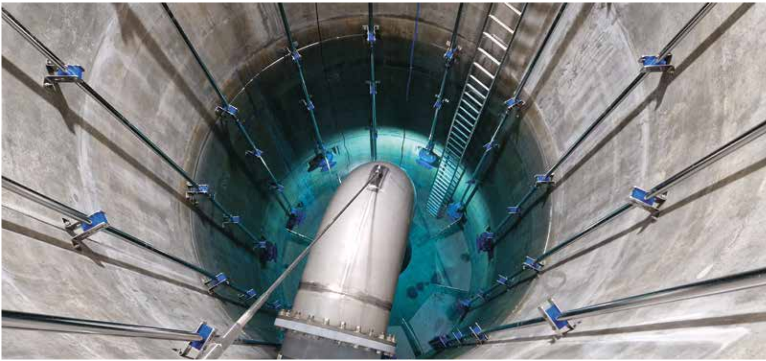
45 – Moderner Horizontalfilterbrunnen in Uttigen.
