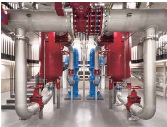
14 – Umfassend saniertes Hauptpumpwerk in der Wehrliau in Muri.
